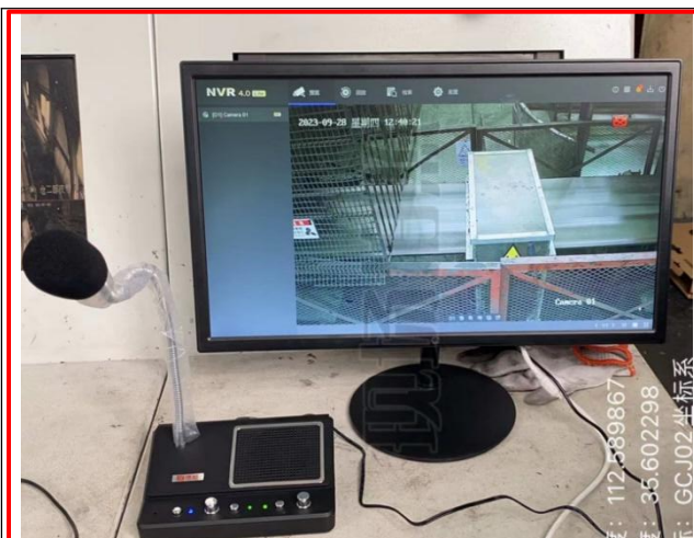
视频监控装置
